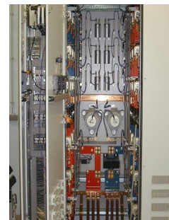
Armoire de distribution
